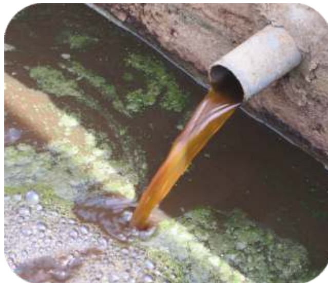
Fotografía 43: Poza de salida de un biodigestor
