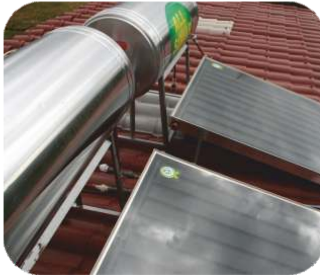
Fotografía 24: Instalación solar térmica
