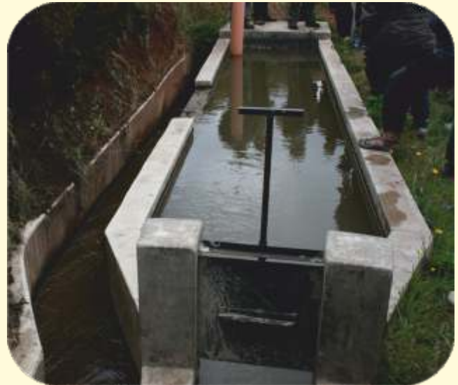
Fotografía 65: Desarenador y cámara de carga
