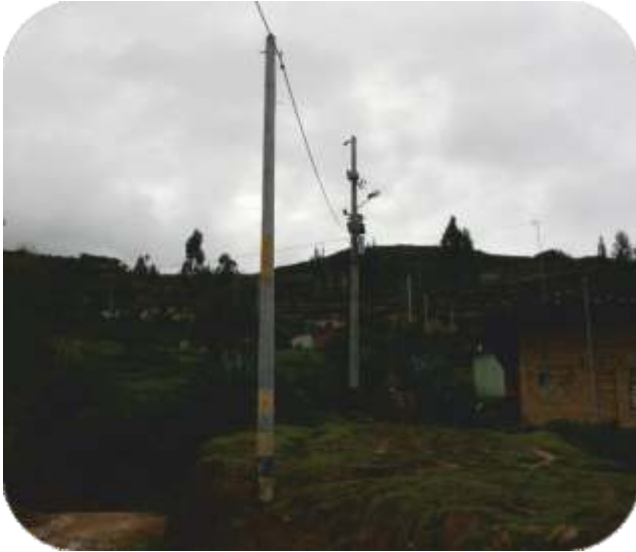
Fotografía 9: Red de Distribución
