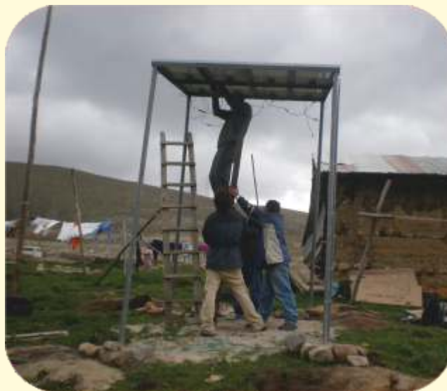
Fotografía 60: Microrred solar fotovoltaica
