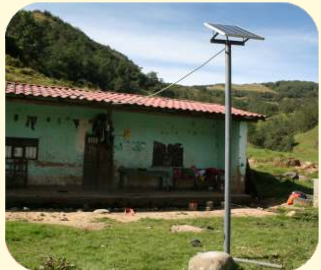
Fotografía 66: Sistema solar fotovoltaico
