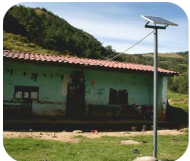
Fotografía 10: Instalación solar fotovoltaica
