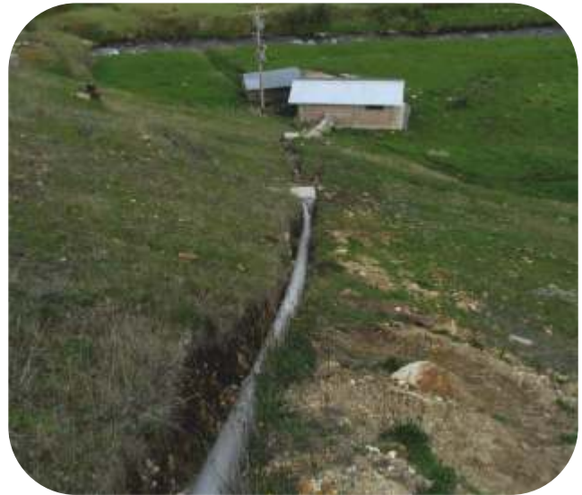
Fotografía 6: Tubería de presión
