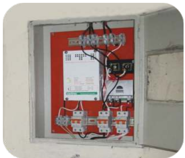
Fotografía 14: Tablero de control de una instalación eólica en Alto Perú
