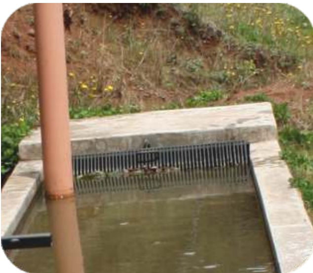
Fotografía 5: Cámara de Carga
