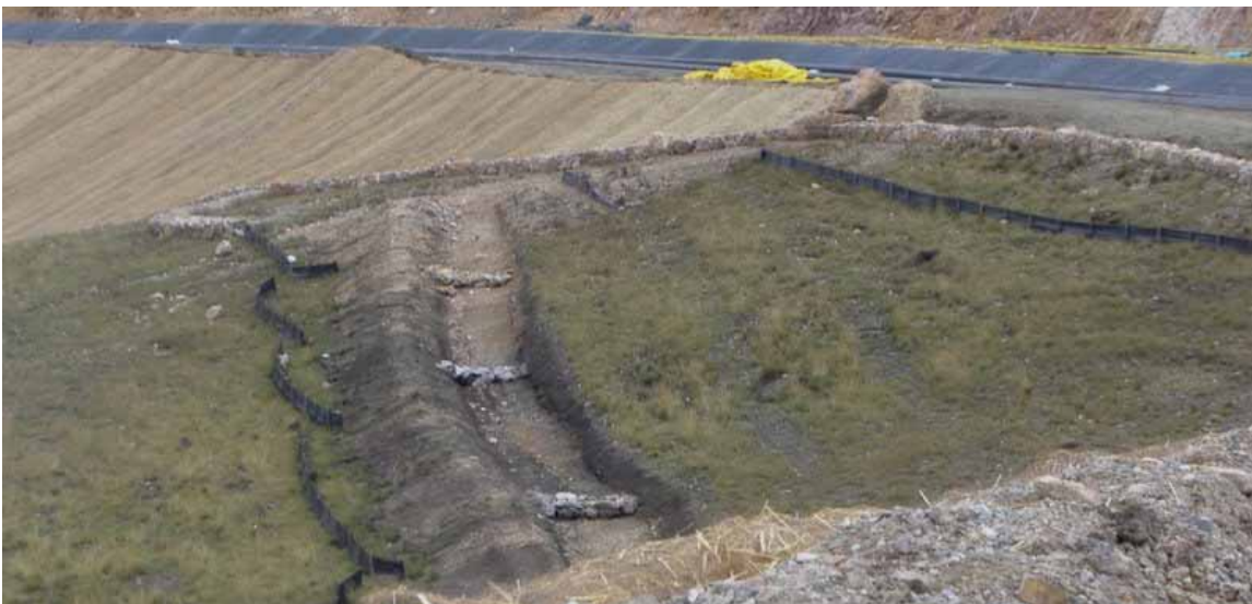
Figura 22: Barrera de control de sedimentos ubicada debajo de la canalización de la pila de lixiviación.
